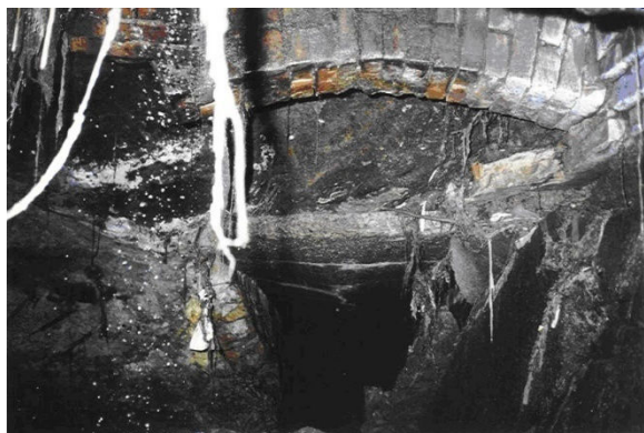
Fot. 1. Zniszczony odcinek kolektora.
